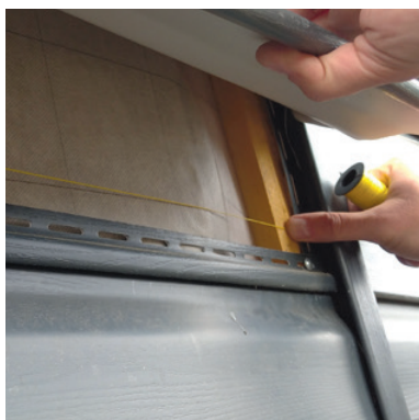
Утеплитель выпирает наружу. Перекрывает вентканал, выталкивает сайдинг.
