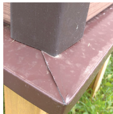
Нет зазора между доборным элементом и отливом.
